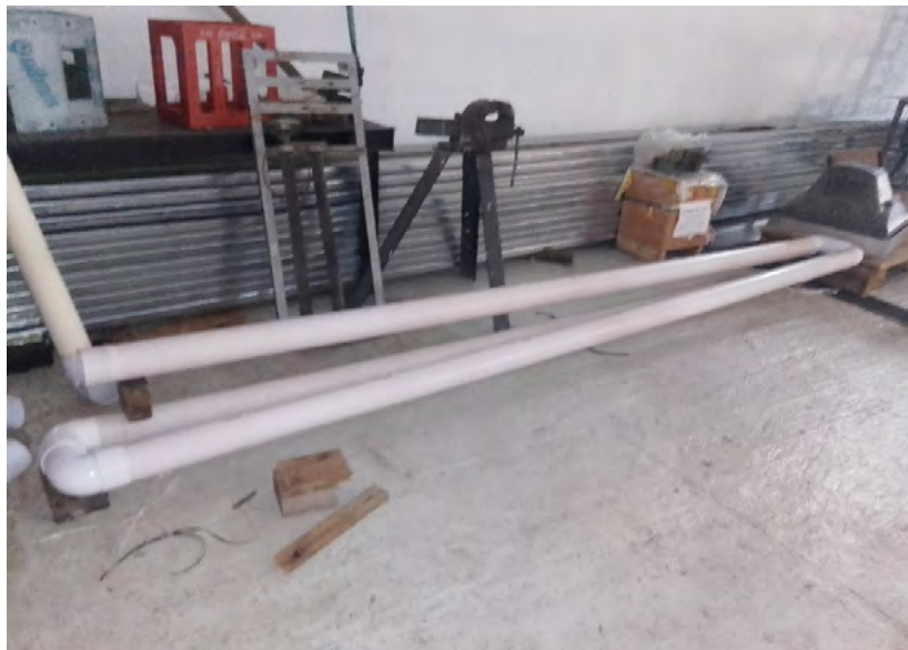
Figura 3. Vista de los tubos de intercambio de calor con el subsuelo.
