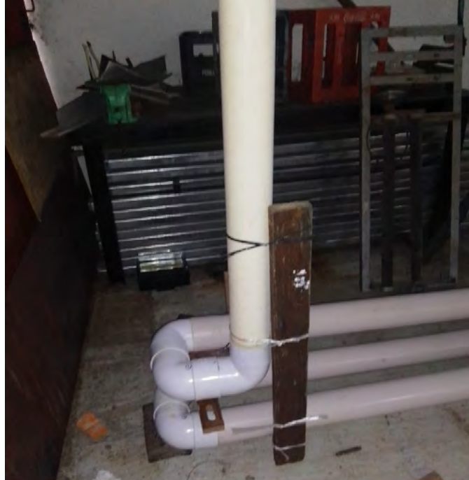
Figura 2. Vista de la entrada de aire al sistema.
